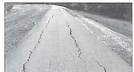
Töltésrepedések az akolhádi szakaszon
