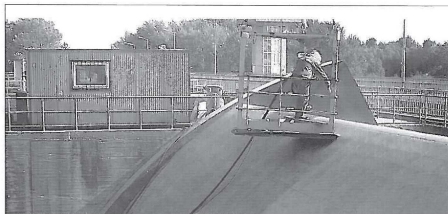
A 2. duzzasztónyílás fölzáróablájának korrózió védelme
