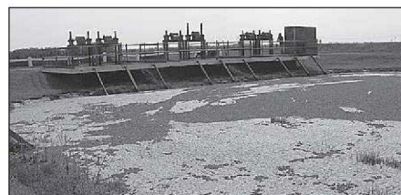
Az Nk.III-2. fűrtfőcsatorna 14. sz. műtárgya
