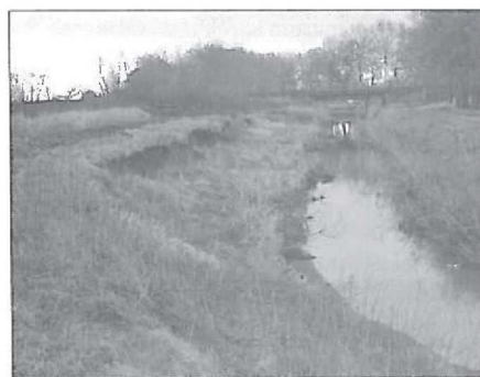
Kakat-főcsatorna rézsűbecsúszás 12+591-12+864 szelvények között
